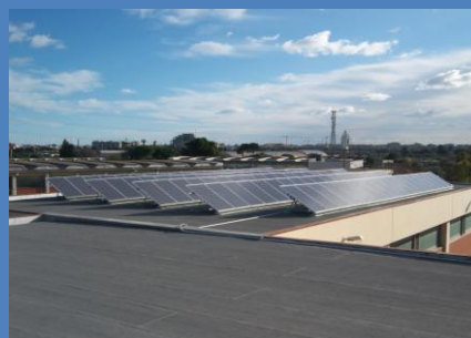
Impianto FV da 19,74 kWp Bari
