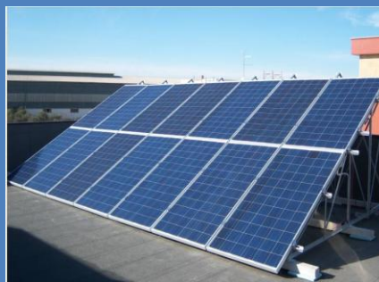
Impianto FV da 4,2 kWp Modugno
