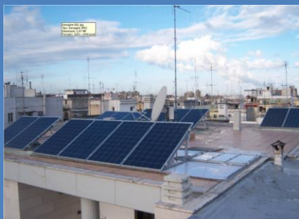
Impianto FV da 3,75 kWp Triggiano
