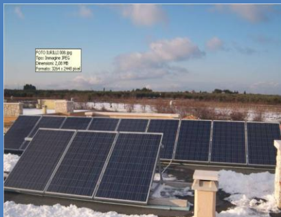
Impianto FV da 3,00 kWp Ruvo
