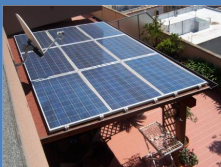
Impianto FV da 2,07 kWp Bari
