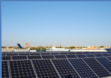
Impianto FV da 18,33 kWp Bari
