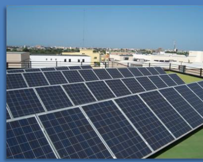
Impianto FV da 18,33 kWp Bari
