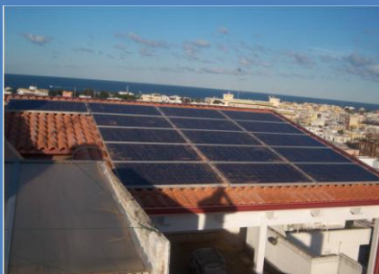
Impianto FV da 4,32 kWp Palese
